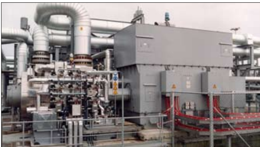
Abb. 3 Magnetgelagerter Elektroantrieb für Erdgaskompressor (23 MW, 600 bis 6300 /min; Werkbild Siemens)
