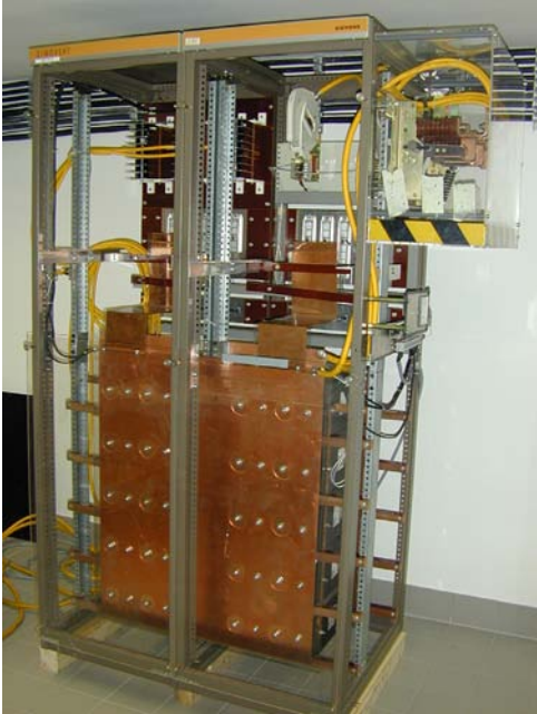
Bild 2: Prüfstand mit Gleichrichterdioden und Zwischenkreiskondensatoren Figure 2: Test bench with rectifier diodes and DC link capacitors
